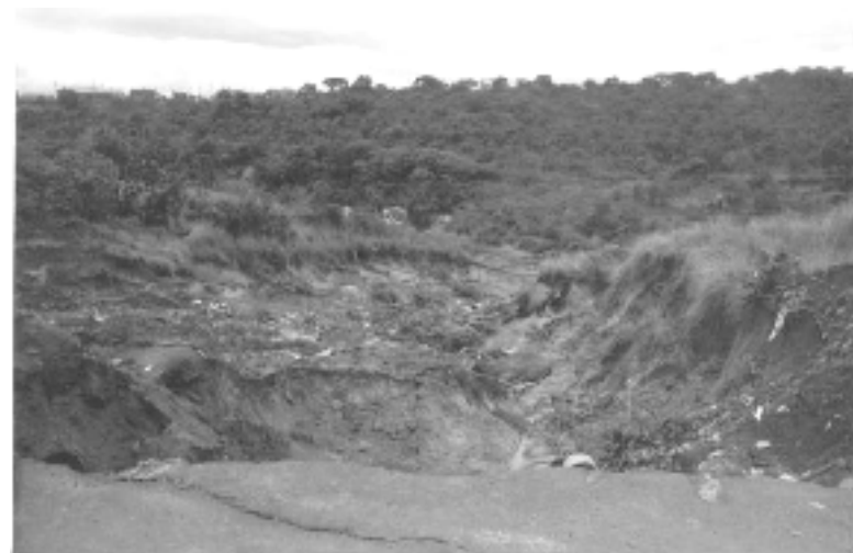
Foto 6. Forma erosiva surgida após o rompimento de galerias pluviais – setor nordeste da cidade de Franca
